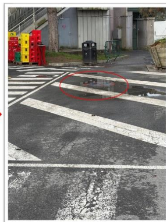
Marquage peu visible. Signe d'interdiction quasi effacé.
